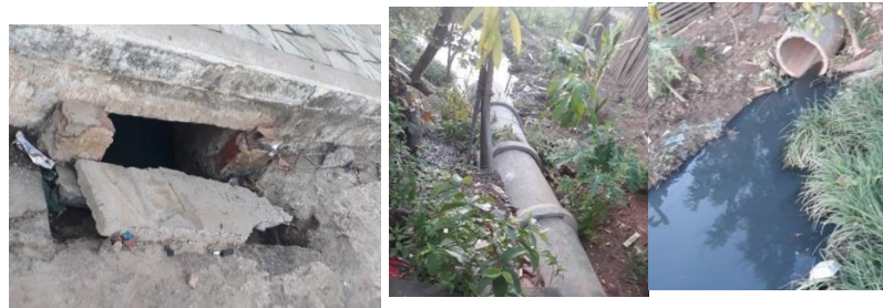
Figura 02: Esgoto lançado no sistema de drenagem urbana
